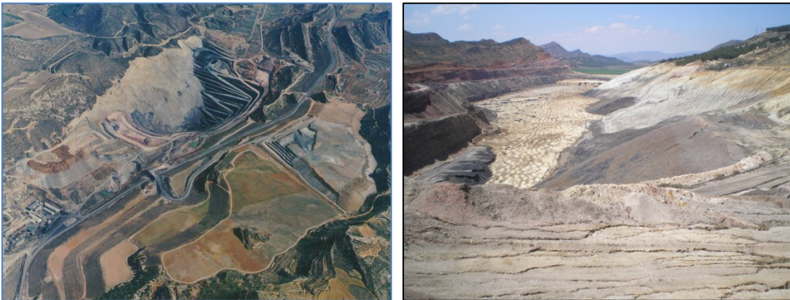
Figura 2. Minería de transferencia y relleno final del hueco residual con yesos de desulfuración en la Corta Barrabasa (Andorra, Teruel) (ENDESA GENERACIÓN, SA)
