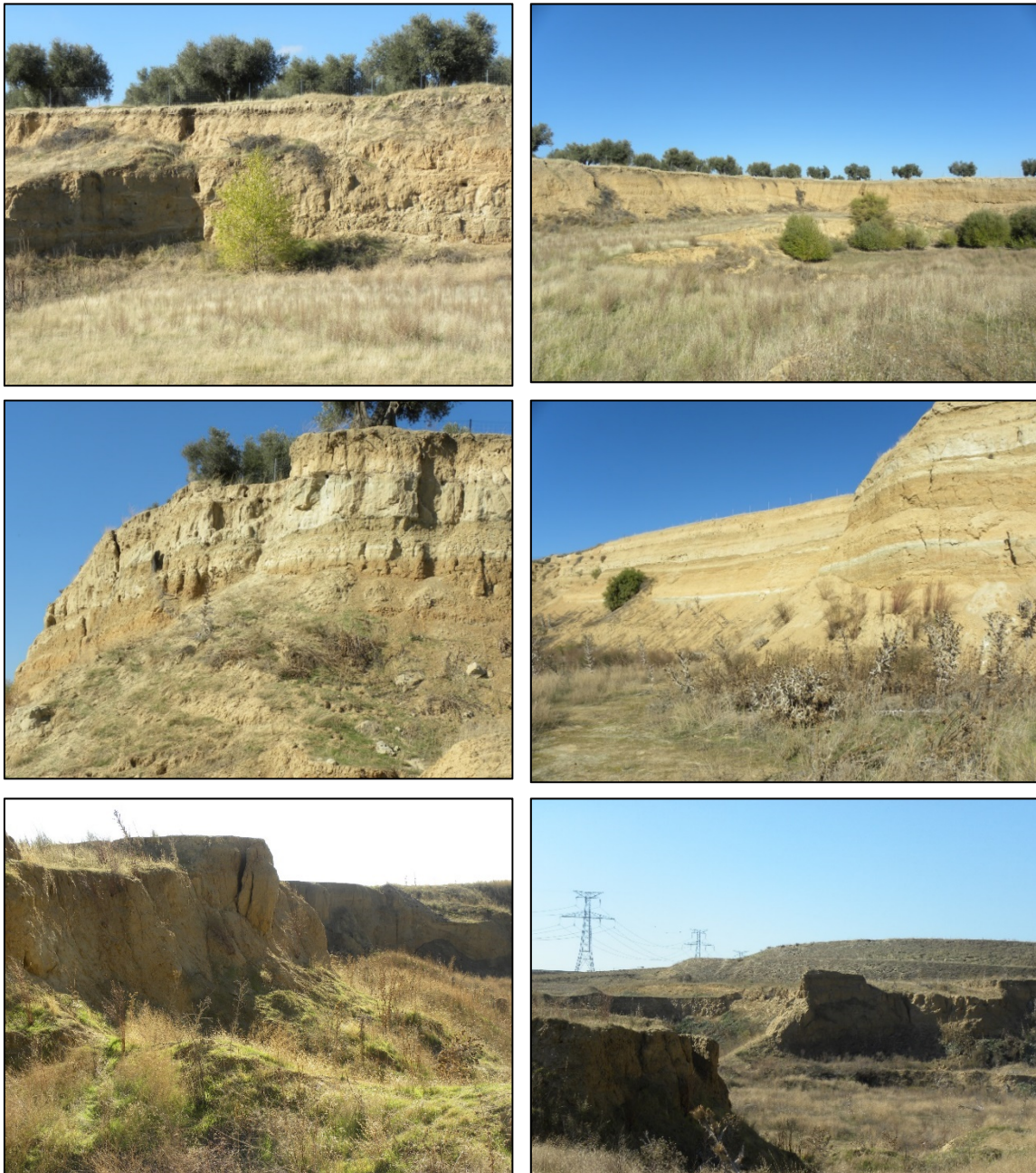
Figura 18. Estado erosivo e inestabilidades de los taludes del hueco de explotación de la cantera Valanzana
