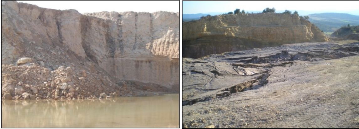
Figura 12. Grietas verticales y desprendimientos en una gravera (izquierda). Grietas de tracción en cabecera de un talud de una explotación de arcillas (derecha)
